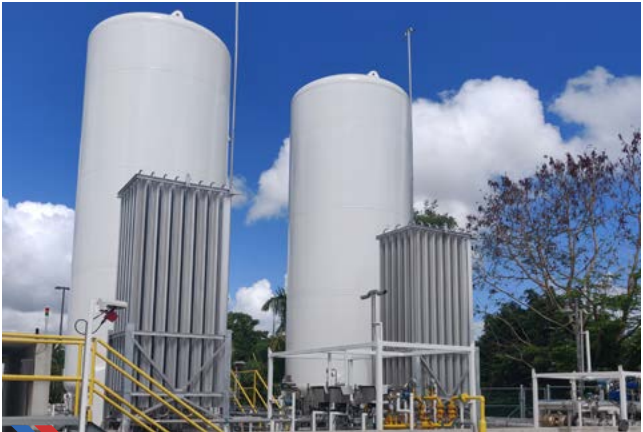
LNG Satellite Station
