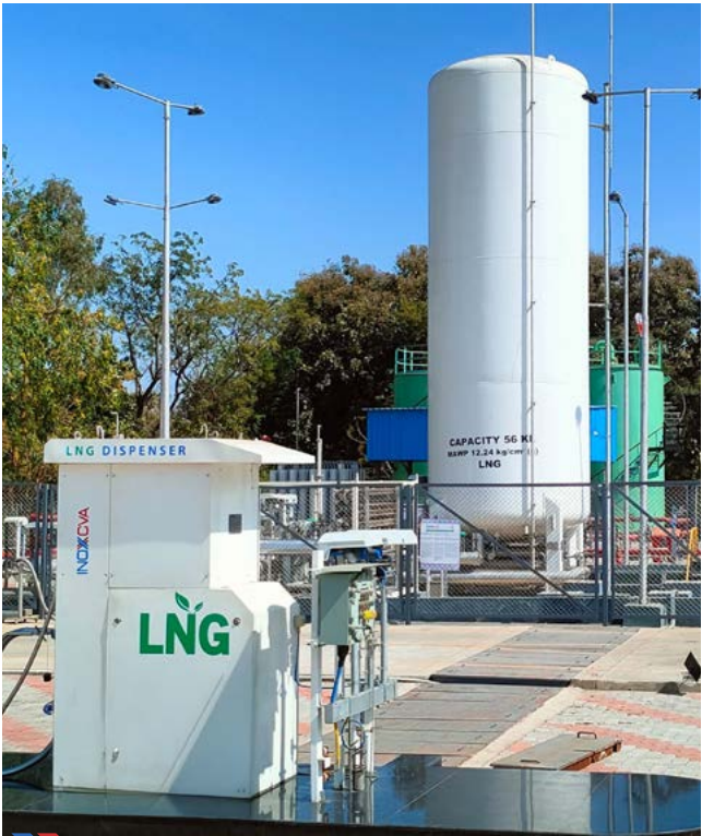
LNG Fueling Station at Gujarat
