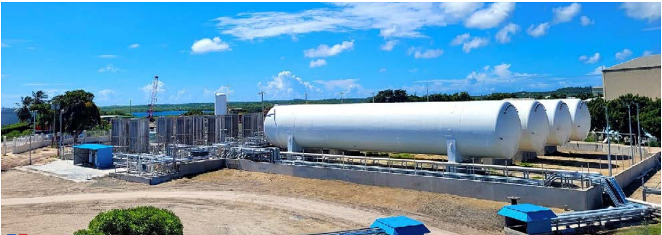
Mini LNG Terminal at Antigua
