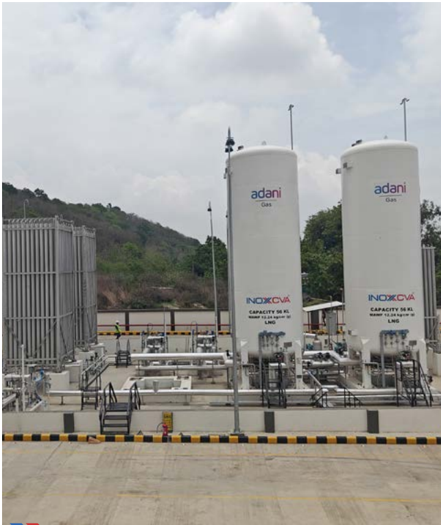
LNG Fueling Station at Gujarat
